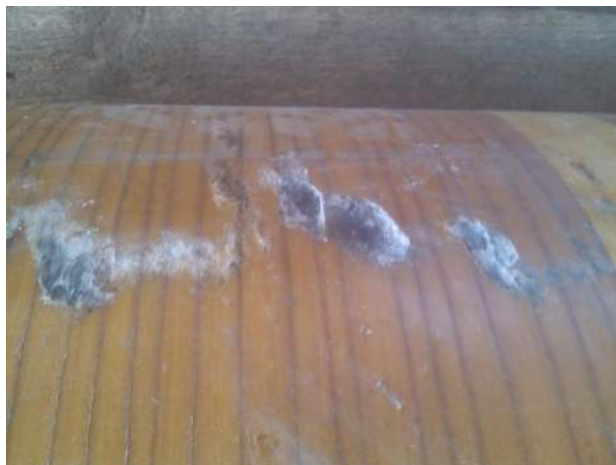
Недопустимо Рисунок 5 – Повреждения(выбоины) от удара
